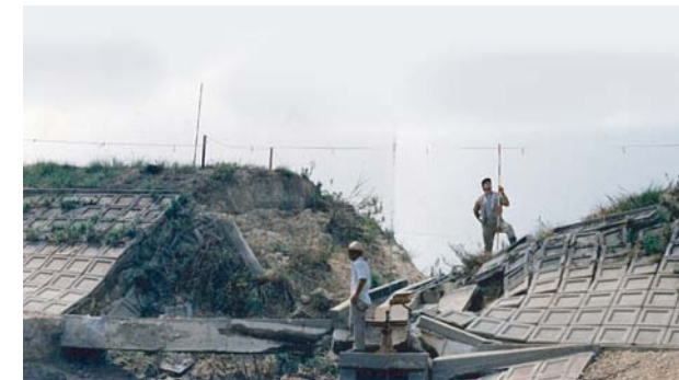
ため池堤体の決壊(市ノ池:兵庫県高砂市)
