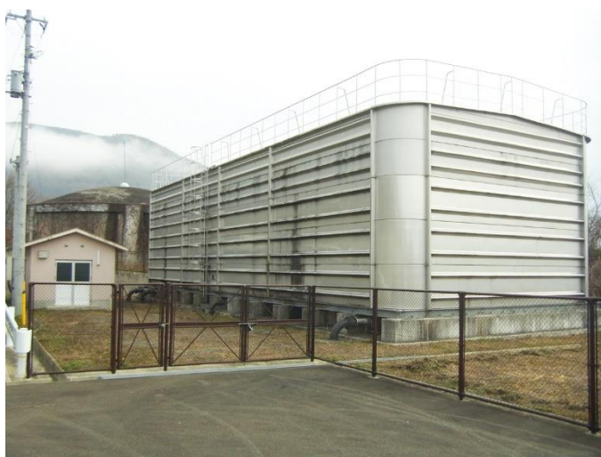
【美馬町 中央高区配水池】
