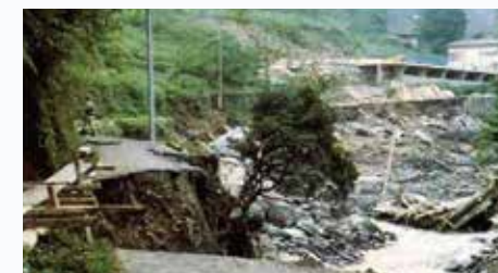
昭和51年台風17号災害(穴吹町古宮 内田線)
