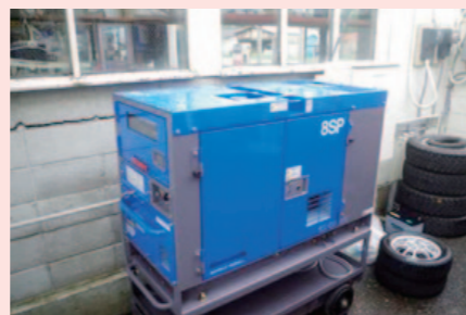
自家発電設備
