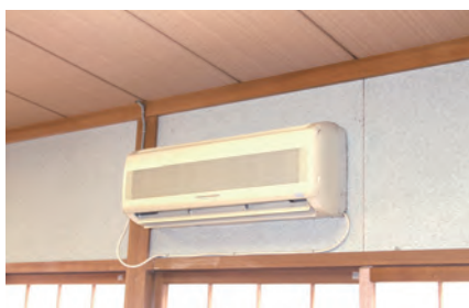
更新予定の集会所空調設備
