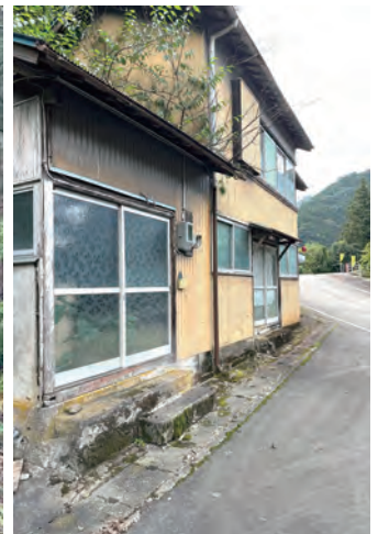
老朽化した施設
