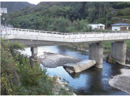
橋脚が倒壊した赤谷橋
