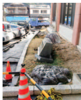
地震動により段差や地盤のうねりが発生 (輪島市役所前総合支所玄関前)
